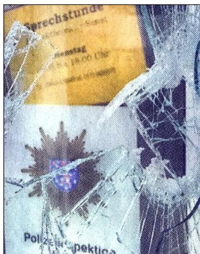
Die demolierte Eingangstür der Silvesternacht
